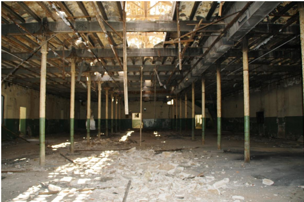
Fig. 21. Sala modernista de Filatures Casals amb pilars de forja a banda i banda. Es pot veure el sostre enfonsat a través del qual s'observa la gòlfa amb els embigats de fusta de melis i el teulat espoliat de teules. Ramon Dalfó.
