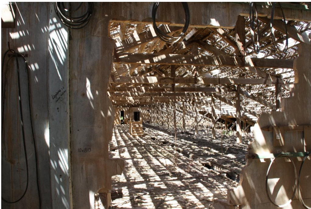
Fig. 22. Golfes d'una de les sales modernistes de Filatures Casals, on s'aprecia l'embigat de fusta de melis que presenta una greu afectació provocada per l'exposició a la intempèrie per l'espoli de teules. Ramon Dalfó.
