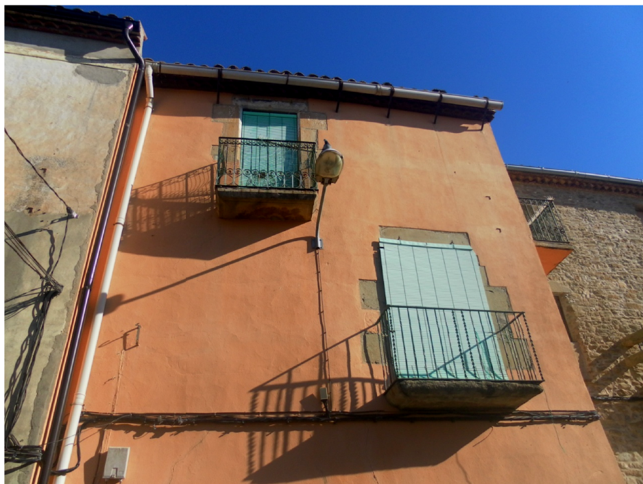
Baixant d'aigües pluvials de PVC
