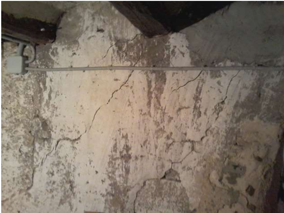
Fissures als paraments verticals
