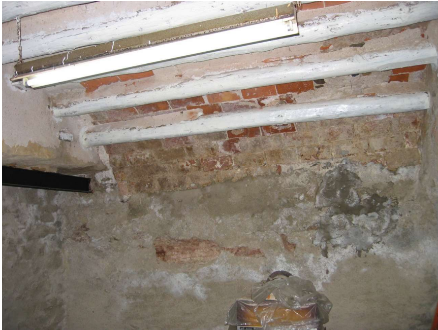
Presència d'humitats al mur de contenció
