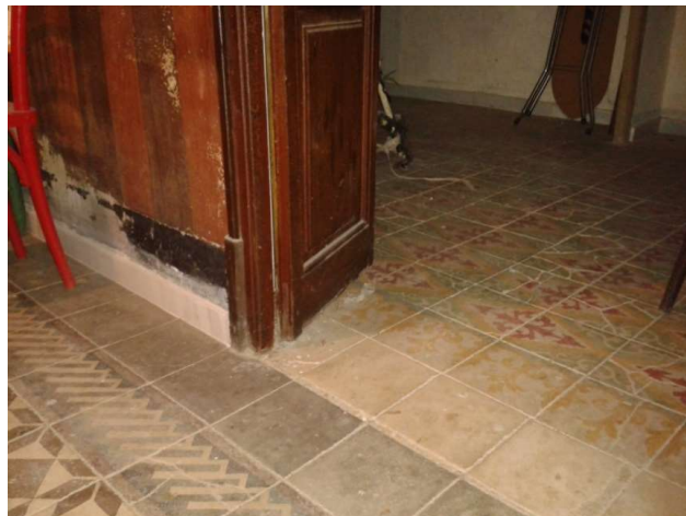
Fissures al paviment del forjat de planta 1a
