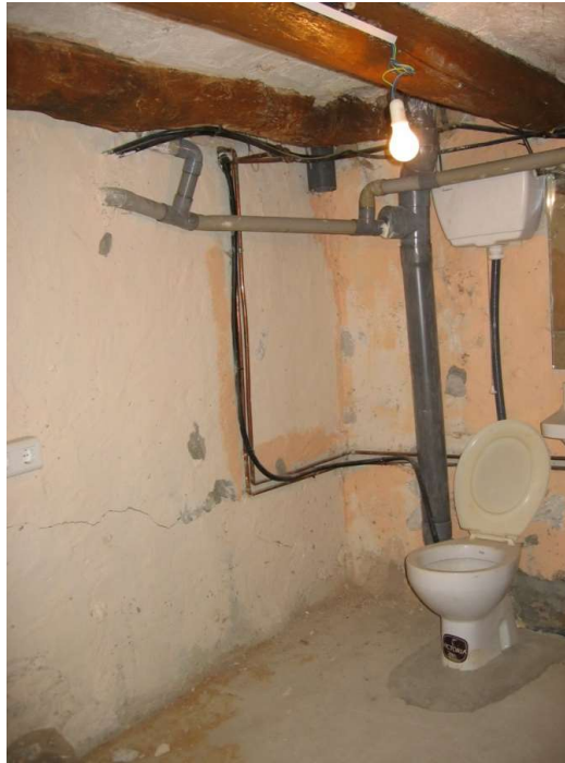
Desgast del revestiment
