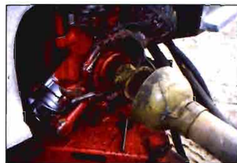
Comprobación de las protecciones de la transmisión de potencia.
