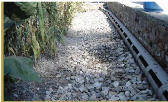
Entrada con tubería ranurada FOTO 2
