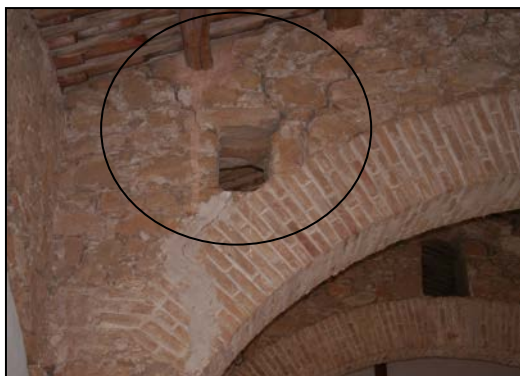
22. Imatge patologies de l'arc
