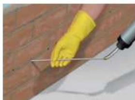
Insertar hasta el fondo del orificio previamente realizado, el tubo de la pistola del SikaMur®-InjectoCream-100
