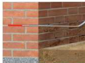
... y rellenar completamente el taladro con SikaMur®-InjectoCream-100 dejando 1 cm hasta la superficie
