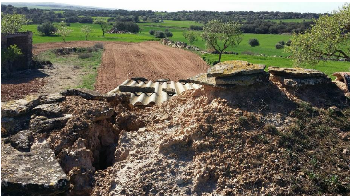
Fig.17.4 Forat a la coberta entre el peto frontal de la façana i la volta
