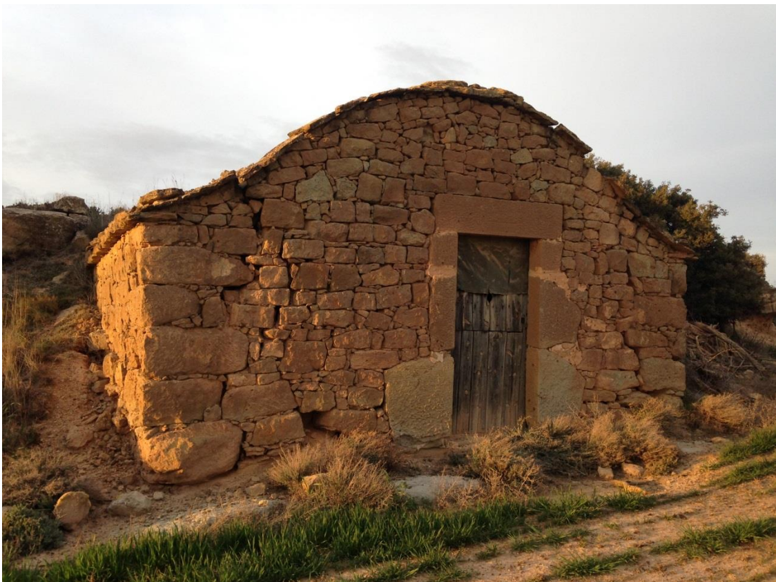
Fig.12.2 Esquerdes de dalt a baix del peto de façana
