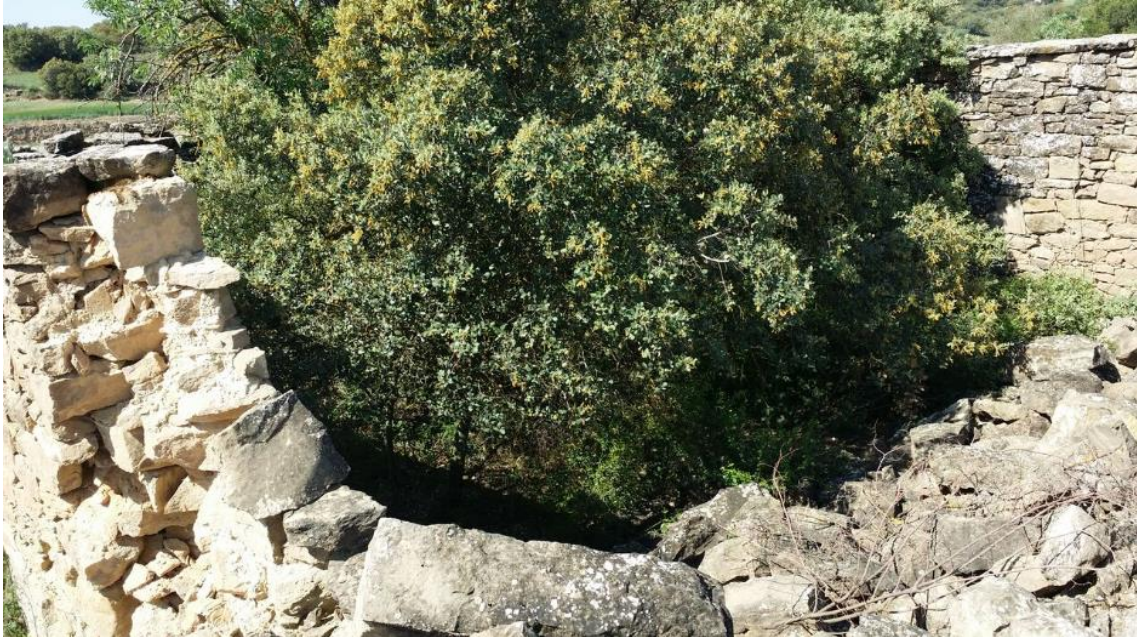
Fig.39.3 Mur lateral dret enderrocat
